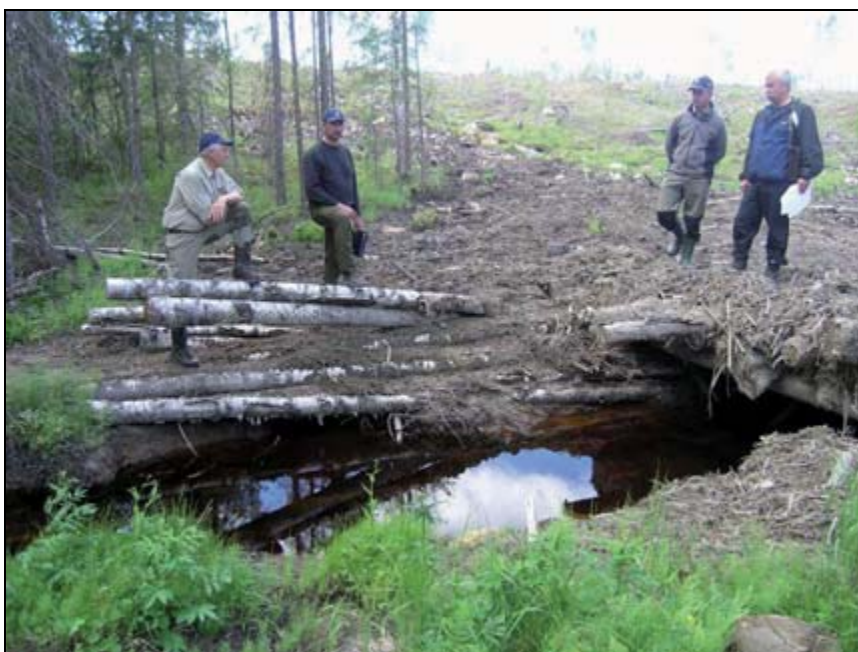
Trots att man byggt en bra bro har körskadorna medfört att slam transporterats ut i bäcken via körspåren. Det är viktigt att på- och avfarten till bron görs så att detta inte kan ske t.ex. genom risning eller kavling. Foto: Per Simonsson.
