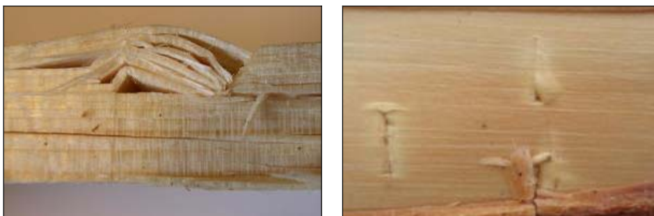
Figur 11. Tvärsnitt och bild på skada från Moipu.
