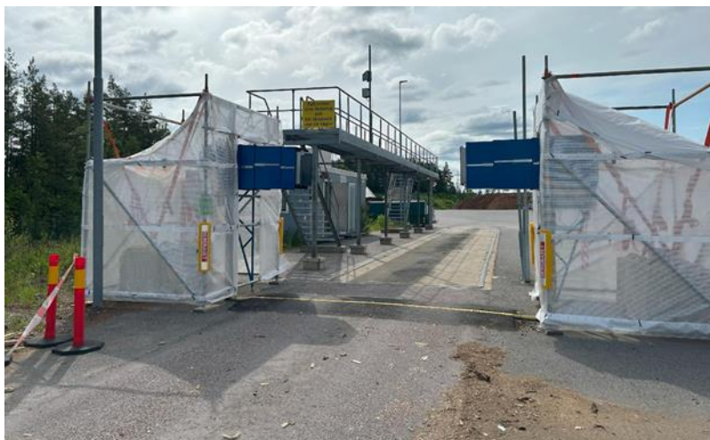
Figur 50. Mätare installerade vid vågen på Johannes biokraftvärmeverk. Foto: Radarbolaget.
