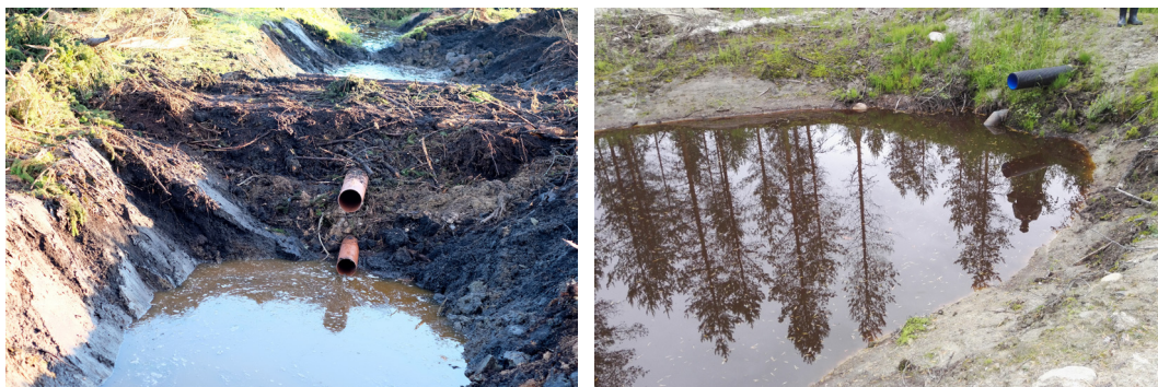
Figur 8. Rördammar installerade inom två av de demonstrationslokaler som etablerades i WAMBAF-projektet (2016–2019), Tobo i mellersta Sverige (vänster) och Vengasjoja i centrala Finland (höger). Observera de två synliga rören (för basflöde respektive höga flöden) i Tobo. I Vengasjoja syns det övre röret för höga flöden tydligt, men rörreduceraren som är fäst vid intaget på det nedre röret för basflöde ligger dold under vattenytan. Foto: Lars Högbom (vänster) och Leena Finér (höger).
