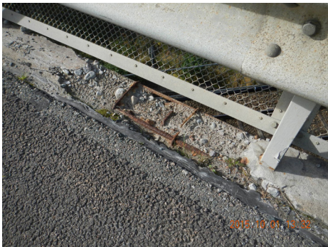
Kantbalk (ovansida) - Spjälkning, armeringskorrosion.
