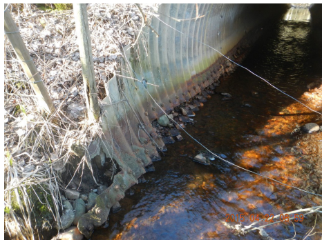
Rörbro - Korrosion, areaförlust 100%.
