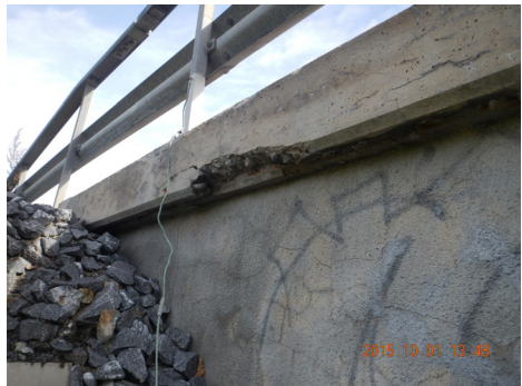
Kantbalk (utsida) - Spjälkning, armeringskorrosion.
