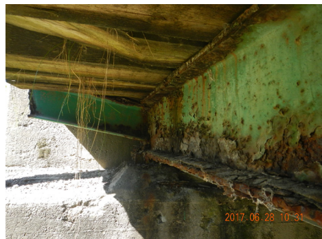
Balk - Korrosion, areaförlust balkflänsar.
