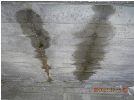
Undersida broplatta - Läckage.
