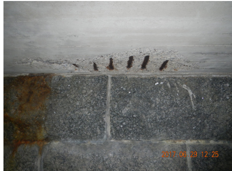
Platta - Spjälkning, armeringskorrosion.
