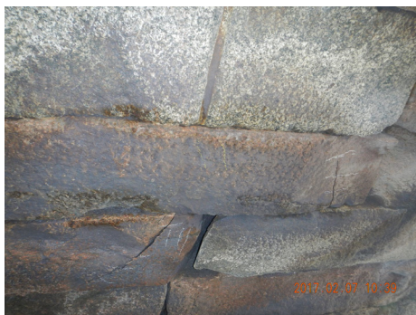
Sten - Sprickor i stensvalv.
