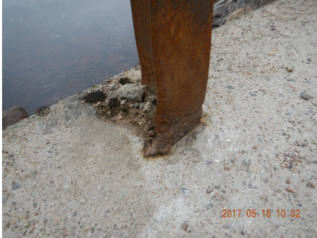
Räckesfot - Korrosion, areaförlust.
