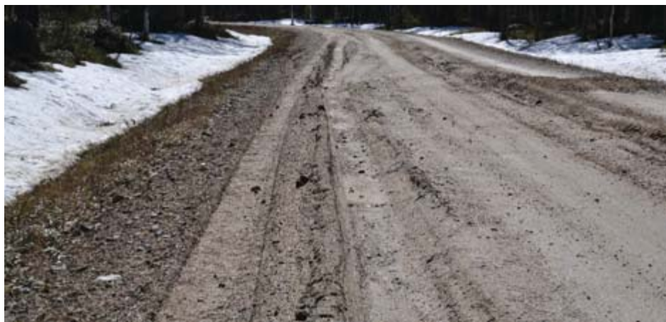
Här saknas det grova materialet. Vägytan blir mjuk och spårig. Foto: Per Hallgren.
