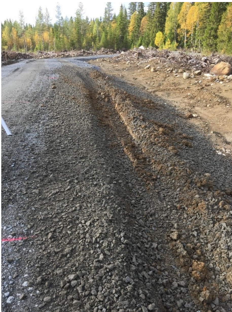
Figur 17. Haveri av provpunkt. Vägmaterial flyttas i sidled.
